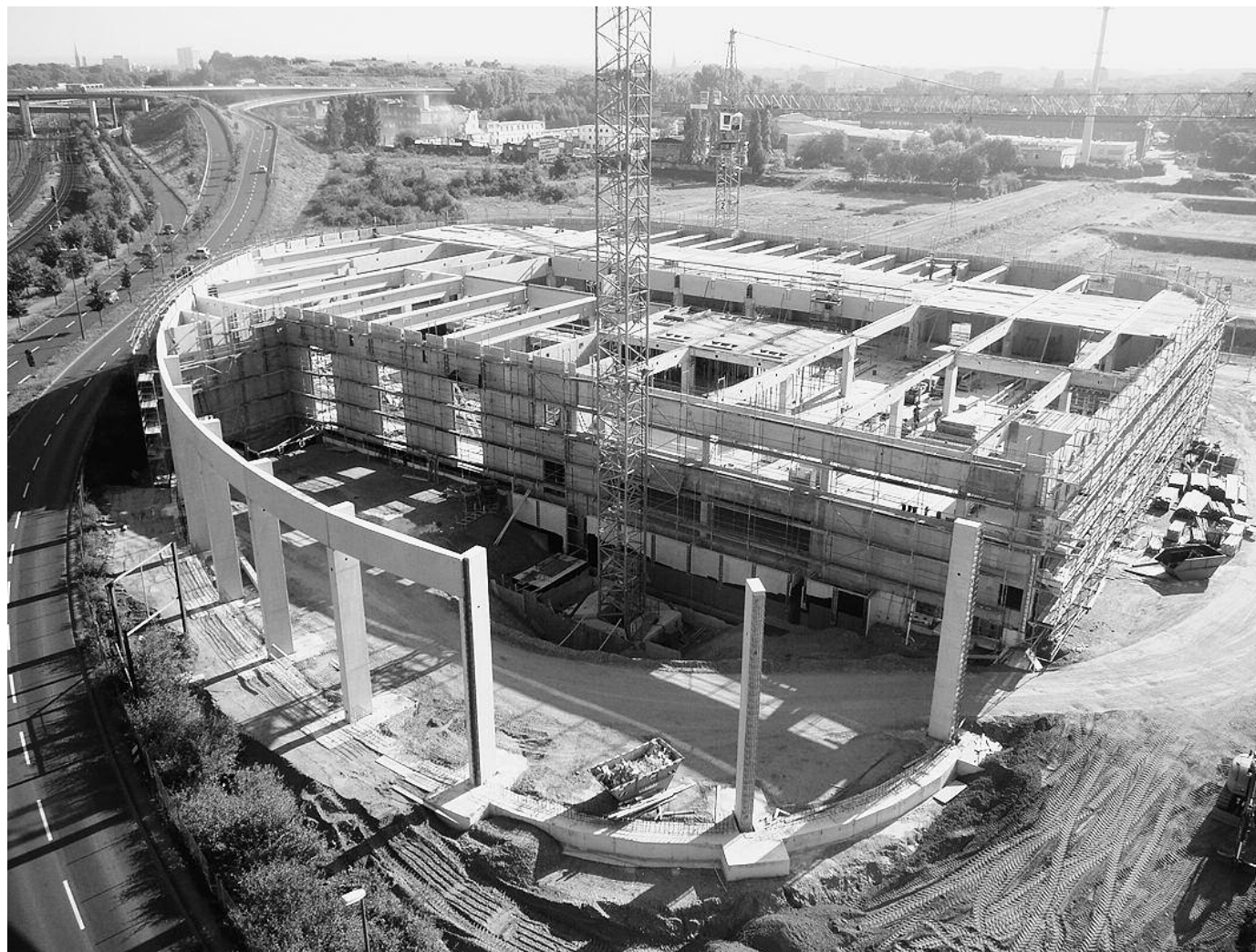
Fertigteil- und Teilfertigteilkonstruktionen mit hohen Spannweiten kennzeichnen den Bau des „Odysseum“. Das Aussteifungskonzept des ellipsenförmigen Baukörpers beruht auf Berechnungen der Tragwerksplaner IDK Kleinjohann. Foto: Kaspar Kraemer Architekten
